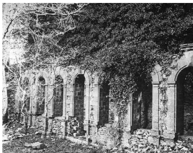
Ruines de l'ancienne chartreuse de la Verne datant du XVIII e siècle, classée monument historique en 1976, située en FD des Maures (83). Ministère chargé de la Culture (photo d'archive).
