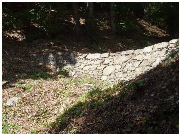
Illustration 198 : seuil d'atterrissement dans un ravin sec. Forêt domaniale RTM de l'Argent double (Aude).
