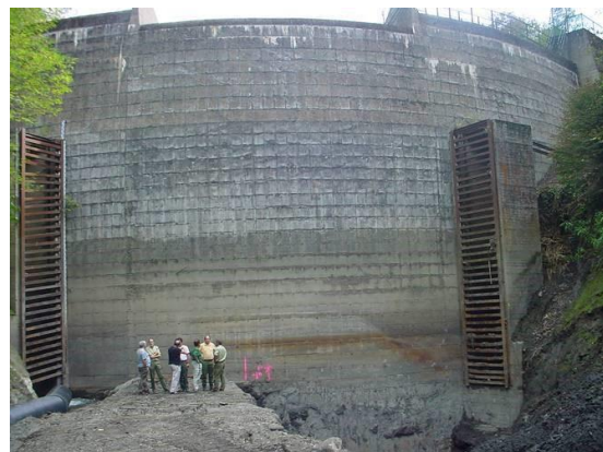
Illustration 205 : barrage de retenue de matériaux. Forêt domaniale RTM de Bagnères-de-Luchon (Haute-Garonne).
