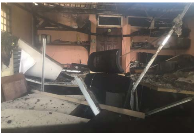
Vue intérieure du Bâtiment B après l'incendie
